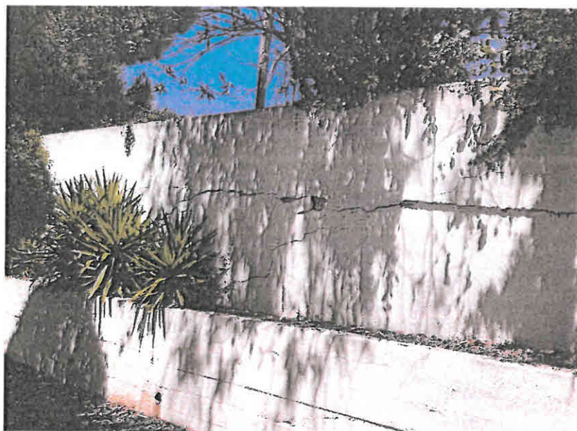
Foto 6 –Fissuração radiada com vestígios de raízes proveniente dos arbustos existentes no tardo do muro e descolamento do reboco
