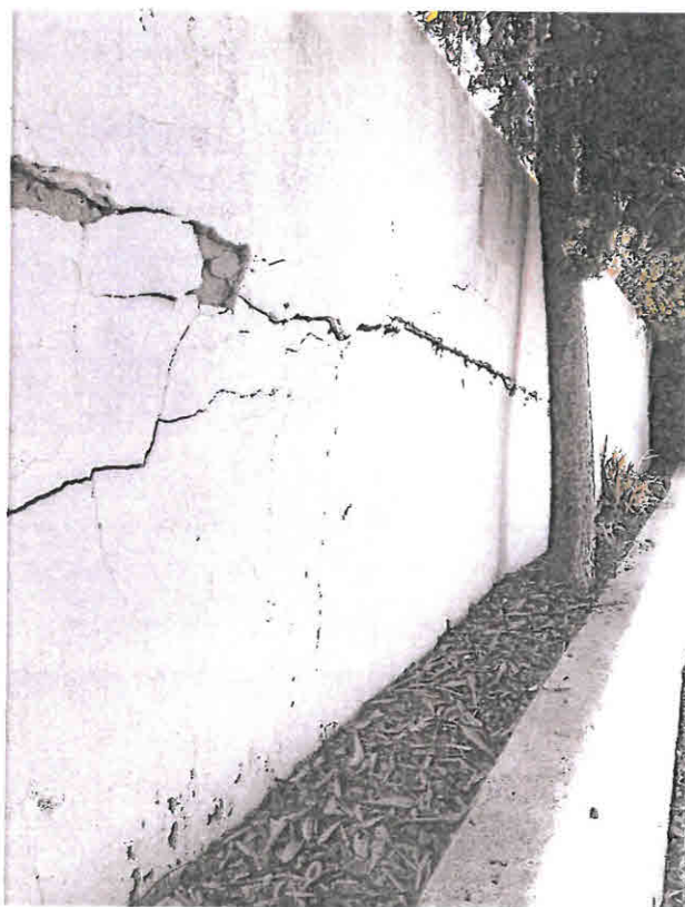
Foto 7 –Fissuração radiada com vestígios de raízes proveniente dos arbustos existentes no tardo do muro e descolamento do reboco
