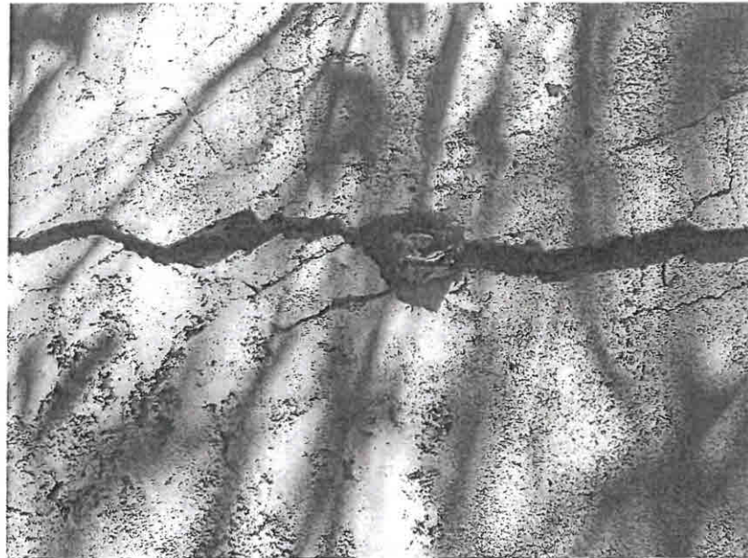
Foto 8 – Raiz do arbusto que atravessou o muro transversalmente
