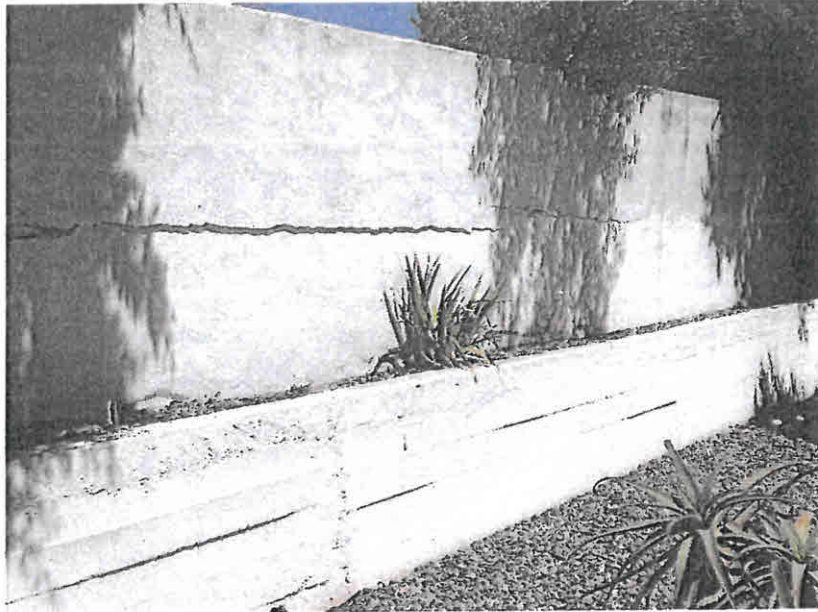
Foto 4 – Fissuração horizontal ao longo da sua espessura e extensão com deslocamento transversal
