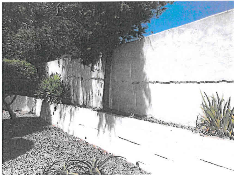
Foto 5 – Fissuração horizontal ao longo da sua espessura e extensão com deslocamento transversal
