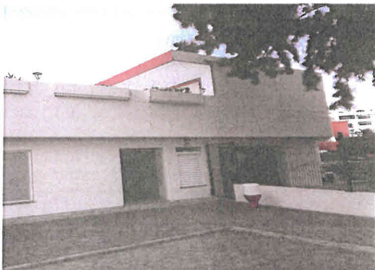
Fotografia n.º 17 - Construção de um anexo sobre a cobertura do edifício designado "Centro Comercial"
