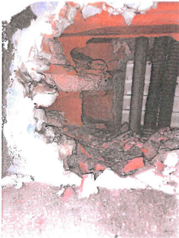
Fotografias n.º 21 - Observou-se, à vista, reboco pintado, material de cor azul, denominado poliestireno extrudido e tijolo
