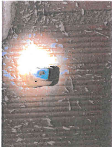
Fotografia n.º 3 - Interior do orifício na parede contigua ao prédio n.º 6
