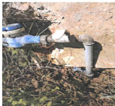
Figura 1 – Fotografia da rotura existente
